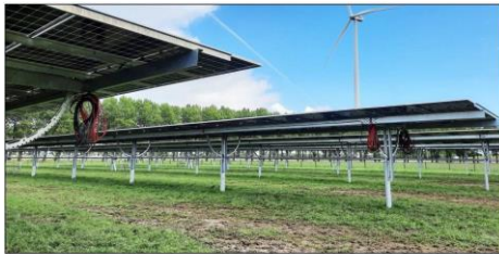
Abb. 1: Agri-PV-Projekt in Mecklenburg – Vorpommern. Foto: Vattenfall!
