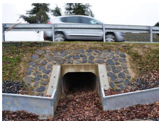
Abb. 28 Beispiel für einen Amphibientunnel.
