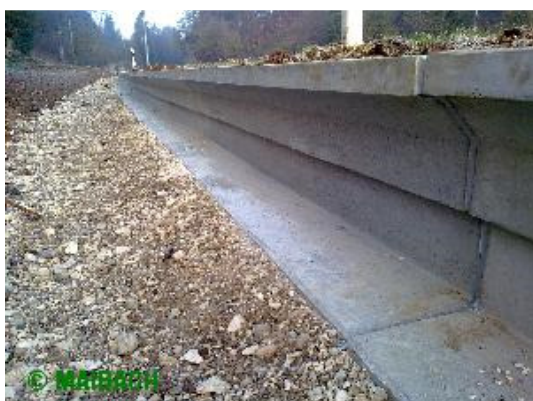
Abb. 27 Beispiel für Amphibienleiteinrichtung aus Beton.
