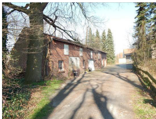
Abb. 37 Baufälliger Schuppen im Zentrum der Vorhabensfläche.
