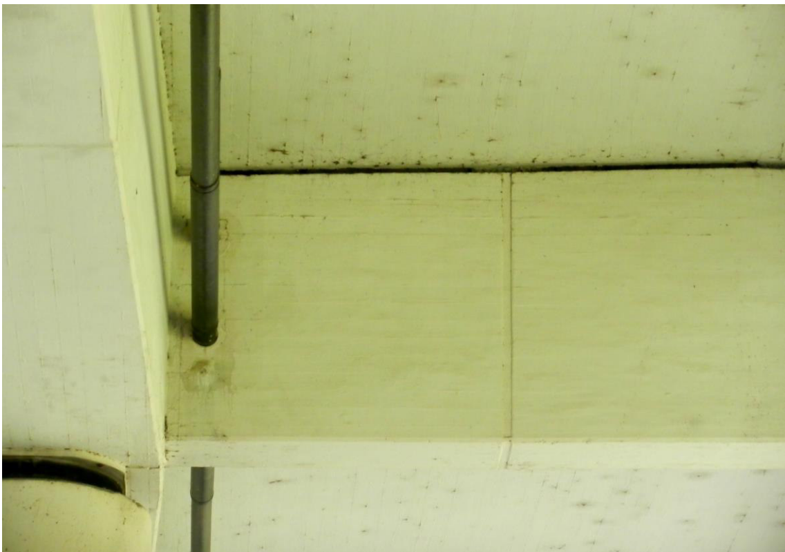
Abbildung 13 Schönwasserparkbrücke; Querträger mit Spaltenversteck
