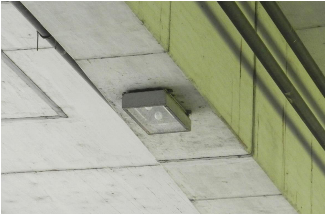
Abbildung 6 Deckenlampe (Brücke Nr. 13, Schönwasserparkbrücke)
