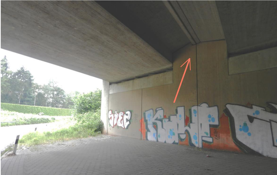
Abbildung 14 Zum Schwärmen bevorzugte Struktur (Pfeil) im Nordwesten der Brücke über südliche Ausfahrrampe der Anschlussstelle Gartenstadt (Brücke Nr. 3)
