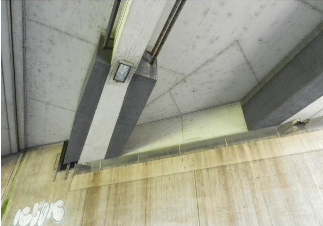
Abbildung 12 Schönwasserparkbrücke (Brücke Nr. 13); teilweise verschlossenes nördliches Widerlager; Beton-Längsträger mit Verstärkungselementen
