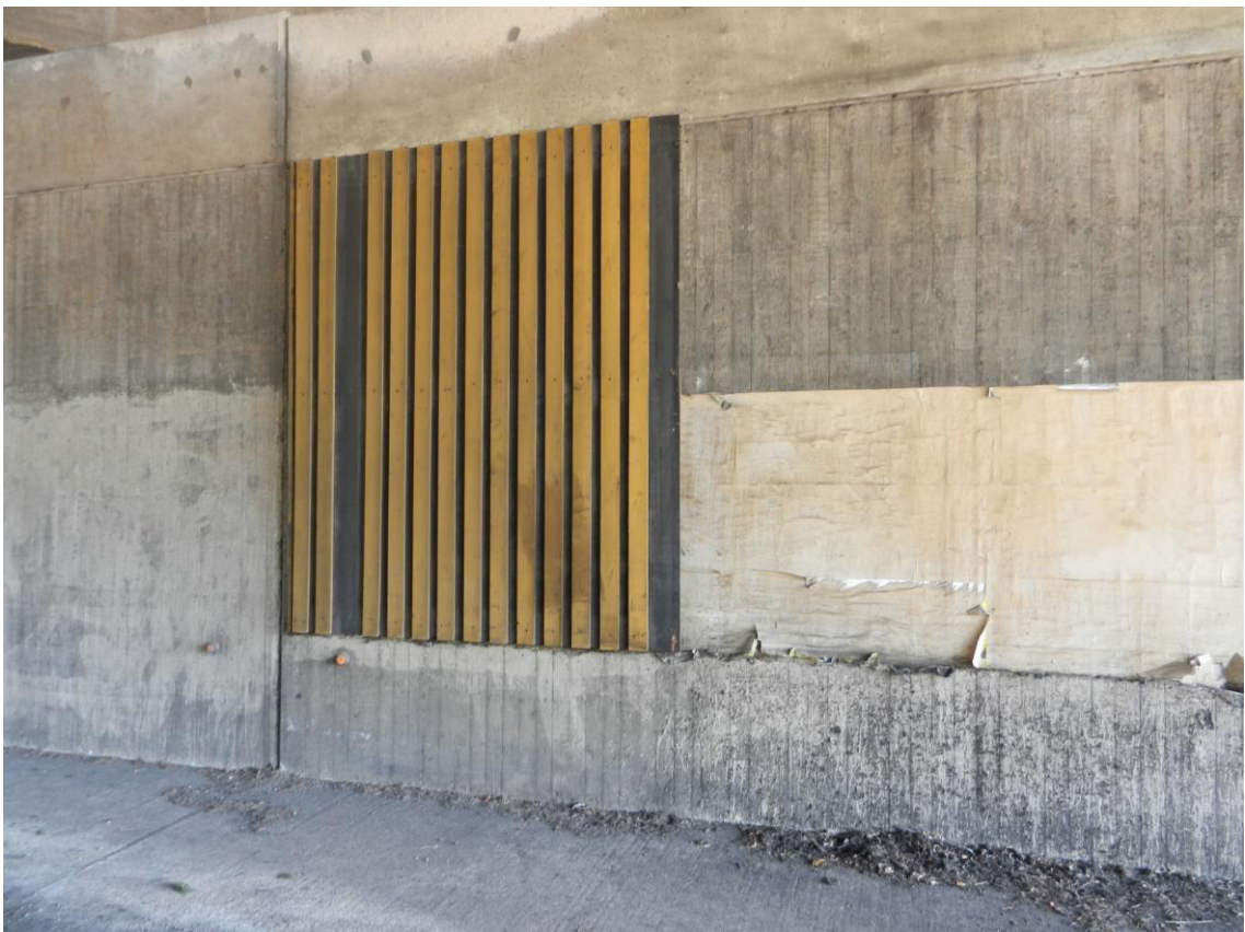
Abbildung 7 Holzvertäfelung an Seitenwand an der Brücke Nr. 10 (Essener Straße)
