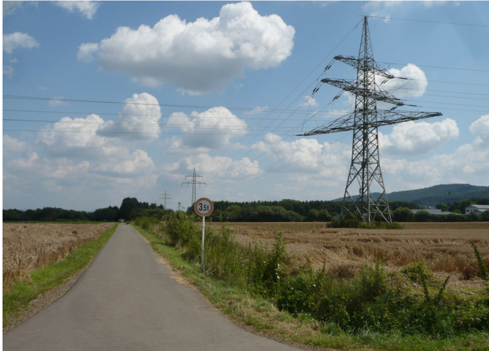
Abbildung 3: Mast 68 der 110-kV-Leitung Rehme - Meißen. Die 110-kV-Leitung Uphausen - Minden/West schließt an der Quertraverse an.
