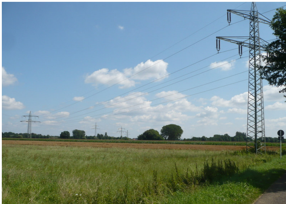
Abbildung 4: Leitungsabschnitt in den Baustauwiesen, Mast 8 (alt) und Mast 7. Im Hintergrund auch Masten der 30-kV-Leitung L455/L456
