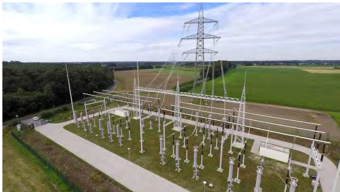
Abbildung 7: Beispiel Kabelübergabestation in Löchte bei Raesfeld (Quelle Amprion)
