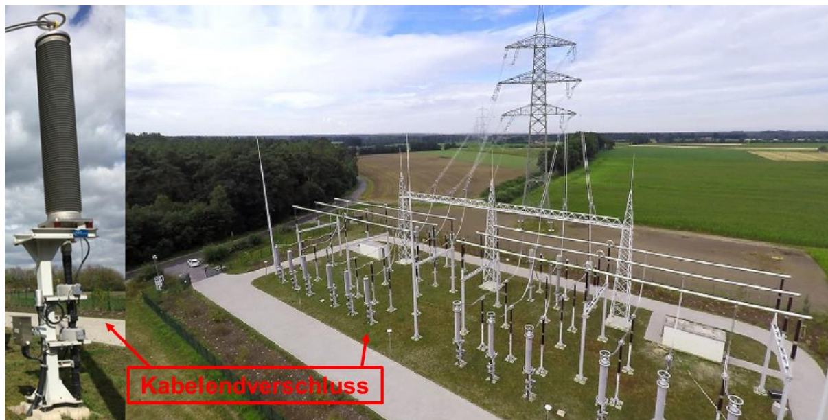
Abbildung 22: 380-kV-Kabelendverschluss (links) und Anordnung der Kabelendverschlüsse in KÜS (rechts)
