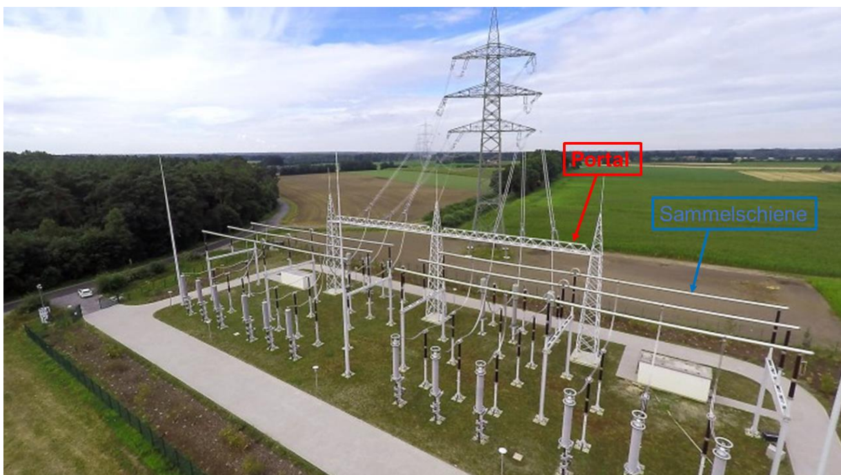
Abbildung 27: Technische Elemente KÜS (roter Pfeil Portale und blauer Pfeil Sammelschiene)
