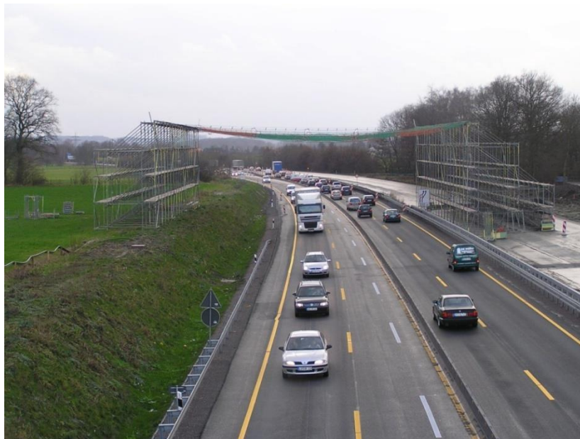
Abbildung 13: Stahlrohrschutzkonstruktion mit Netz über einer Autobahn
