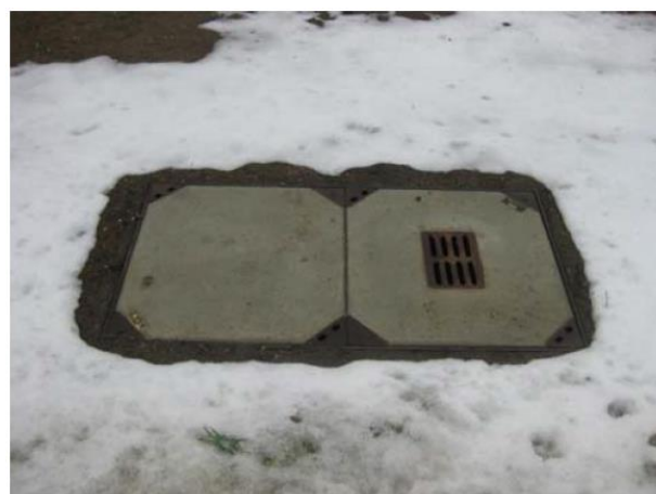
Abbildung 21: Cross-Bonding-Schacht im Betrieb
